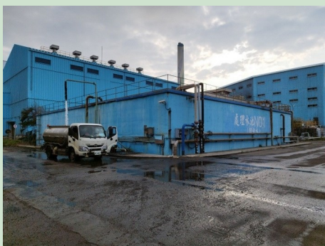
回收水取水站(台中電廠)
