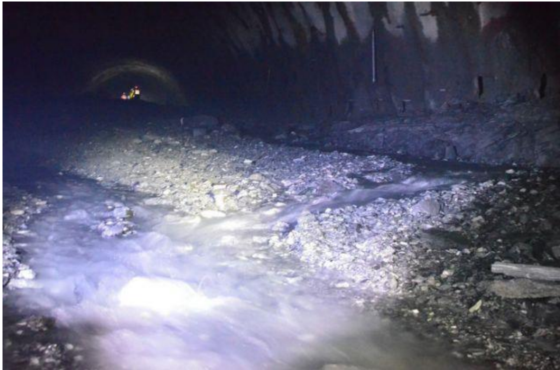
圖 9 B3 標谷風隧道抽坍
