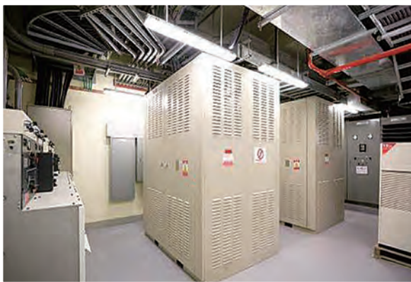
車站22KV變壓器
