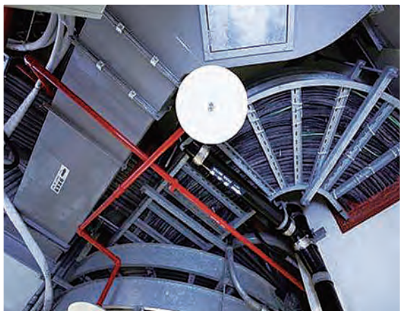
風管與電纜槽架
