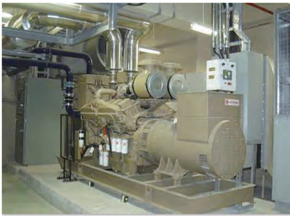
緊急柴油發電機
