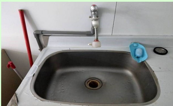
節能減碳-水龍頭裝設節水裝置
