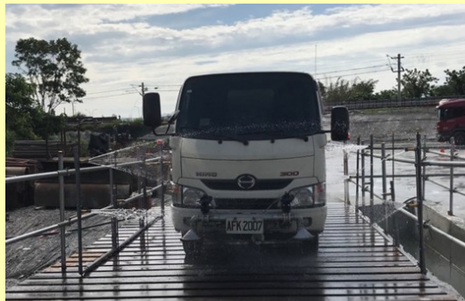
安衛措施-洗車台
