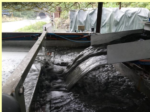
安衛措施-污泥餅製作
